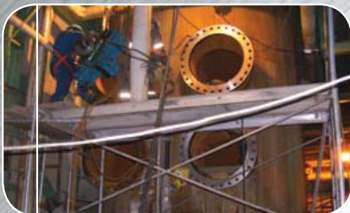
Resurfaçage de brides de conduit dans une usine de transformation lors d'un arrêt planifié
